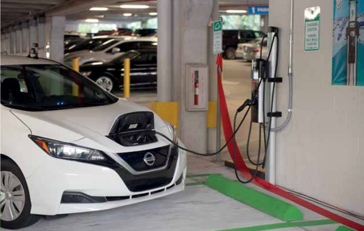
Carga de vehículos eléctricos en LEED Gold del condado de Miami-Dade. Crédito de la Foto_ Condado de Miami-Dade
